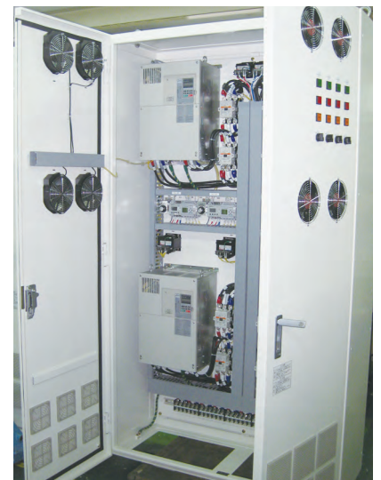
■エコインバータ制御盤内部
